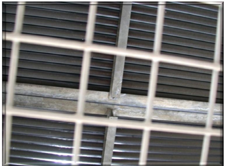
Clean Fin Fan
